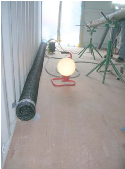
Bild 10, ovan till höger. Tilluftsfläkten placerad 0,5 - 1 m från tilluftskanalen för att minska tilluftsflödet eftersom fläkten inte kunde regleras. Fläkten blåste mot tilluftsfröret. Kanalöppningen delvis också igentejpad för att minska tilluftsflödet.
