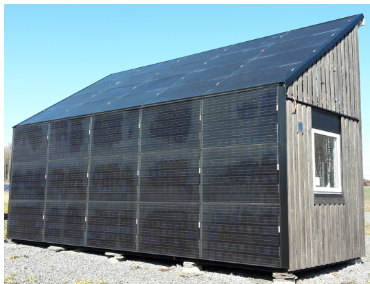
Figur 9: Testanläggning för batterilager med solceller i Glava, 2016
