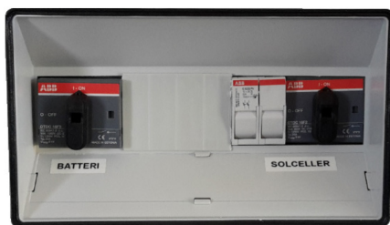
Figur 16: DC-brytare på en småskalig solcellsanläggning med batterilager, Glava 2016
