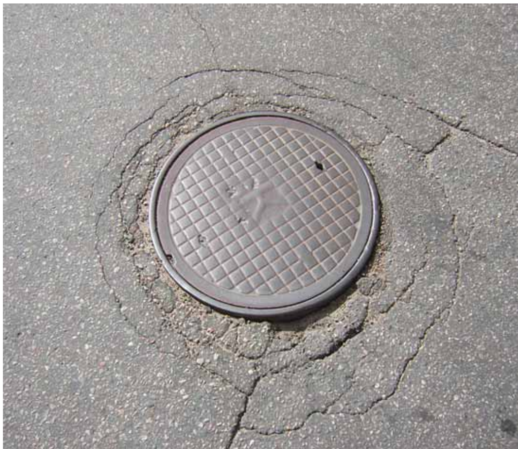
Typisk skada i asfalten runt ett brunnslock
