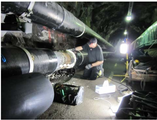
Bild 1. Fjärrkylarör på ena sidan av tunneln och fjärrvärmerör på den andra sidan.
